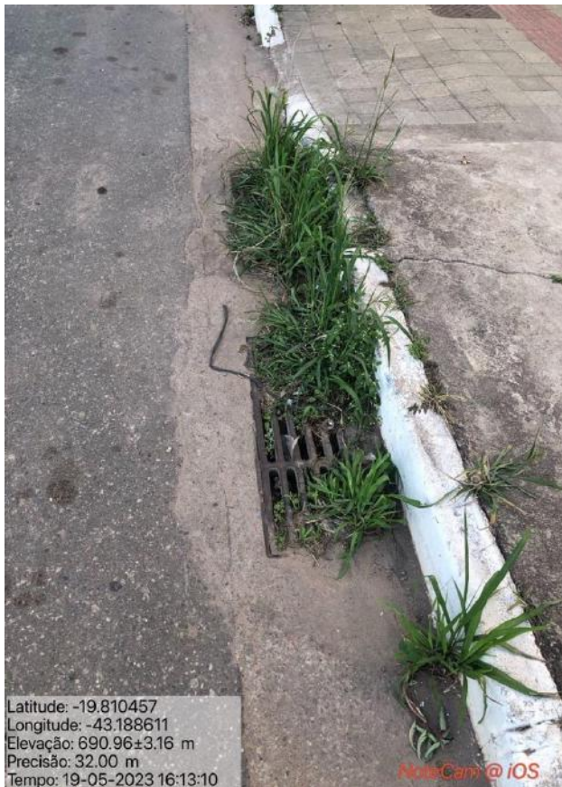
Fig.11 – Obstrução de dispositivo de drenagem
