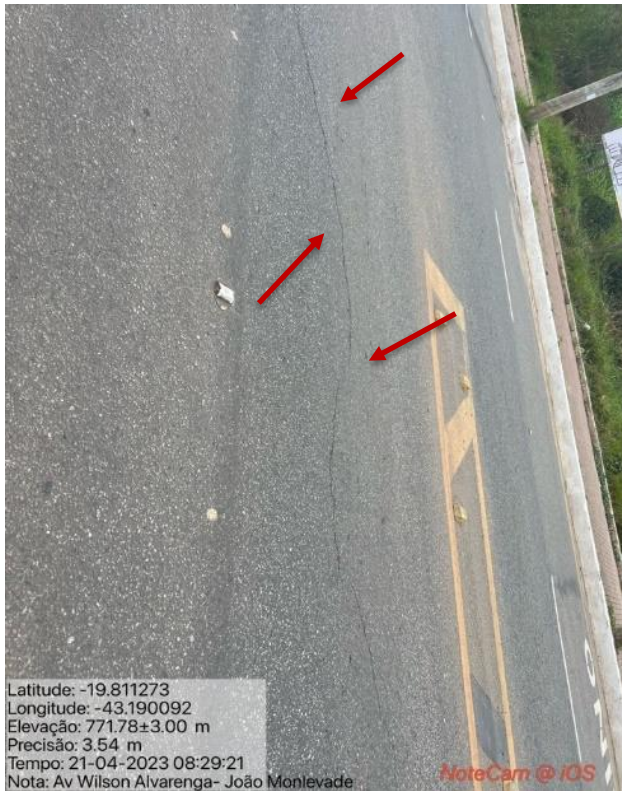
Fig.9 – Trincas Isolada Longitudinal Longa
